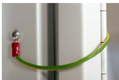
Türen sind separat geerdet
